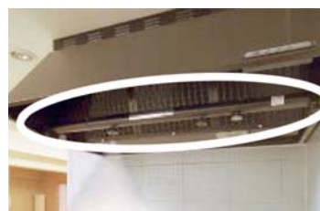
自動消火装置
