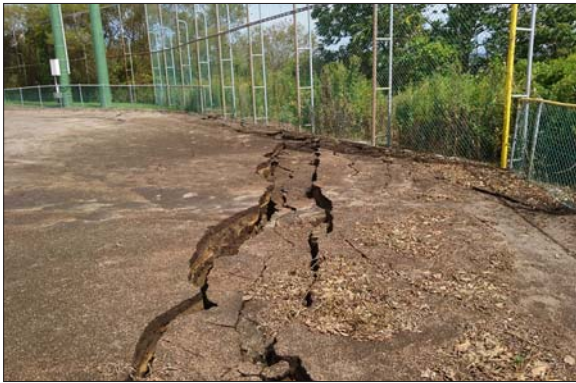
大きな亀裂が入った富川球場内
