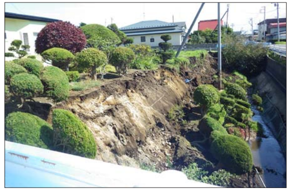
護岸が崩壊したミドリ川
