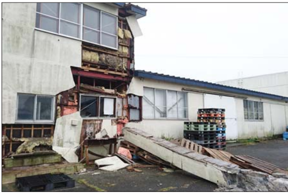
煙突・壁の一部が崩壊したひだか漁業協同組合富浜事業所
