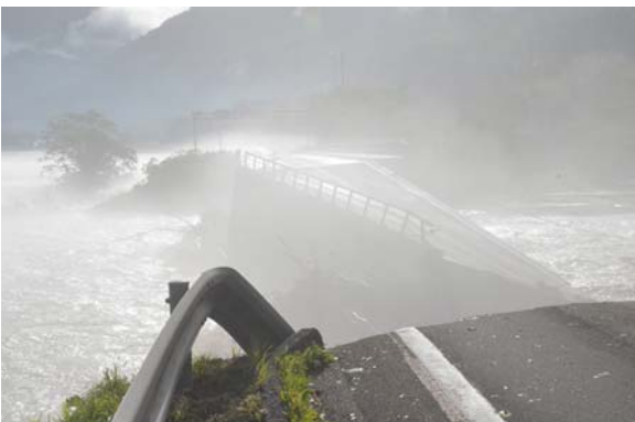
落橋した千呂露橋(国道274号)
