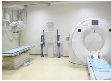
①CT・レントゲン室
