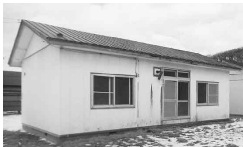
▲老朽化した職員住宅(元町地区)
